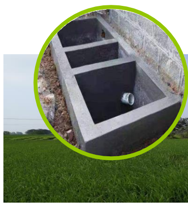
农村生活污水治理
